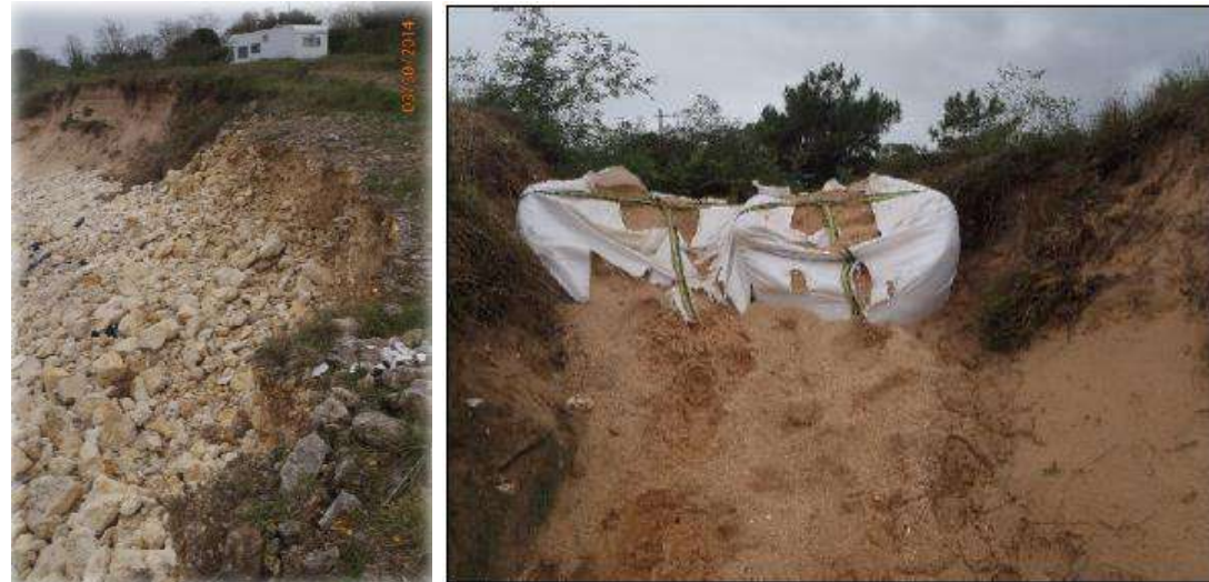
Figure 21 : Erosion dans le secteur Ostréa (gauche) - Sac de sable protégeant la route (droite) - Source : RNN Moëze-Oléron
